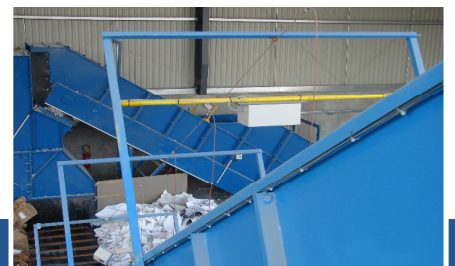
system ochrony obsługi oraz linka wyłączania awaryjnego na szczycie części wznoszącej
